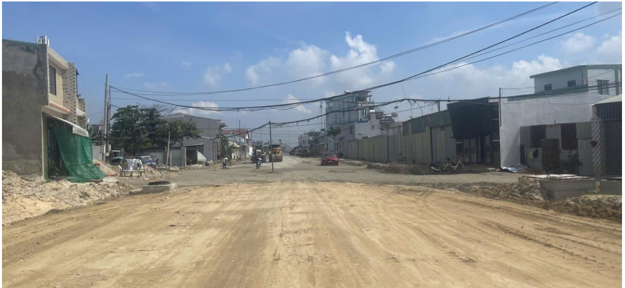
Hình ảnh vị trí nâng cao dây cáp Đường Quy hoạch A4 giao Rạch Bà 1
